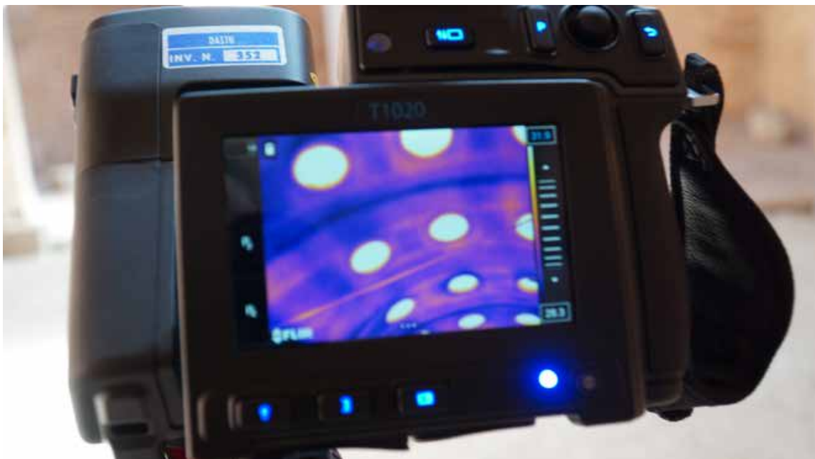
Figura 8: Immagine termografica su BLOCCO 9. Viene evidenziata la presenza di alcuni elementi “tipo nervature” tangenti ai lucernai mentre le fascie più scure si trovano in corrispondenza dei filari di mattoni esterni giustapposti alle volte.
