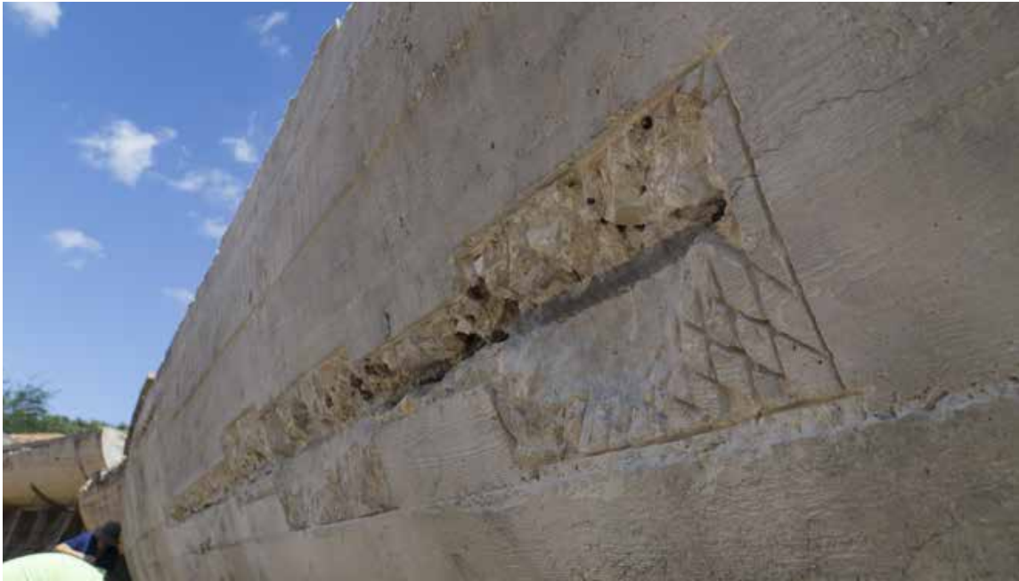
Figura 9: Scassi di vare forme geometriche in corrispondenza dei ferri scoperti
