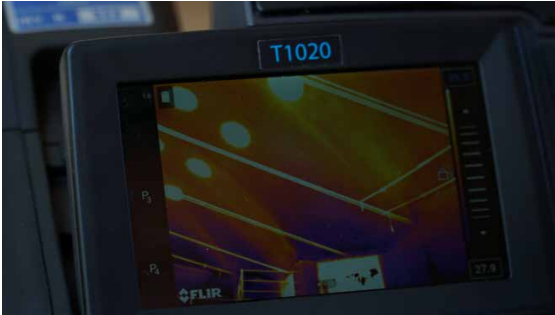
Figura 7: Immagine termografica su BLOCCO 11. Viene evidenziata la presenza di alcuni elementi “tipo nervature” tangenti ai lucernai.
