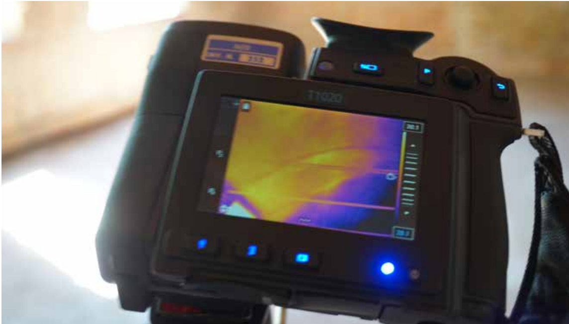
Figura 4: Immagine termografica su BLOCCO 1. Viene evidenziata la presenza di alcuni elementi “tipo nervature” o ferri sulle volte
