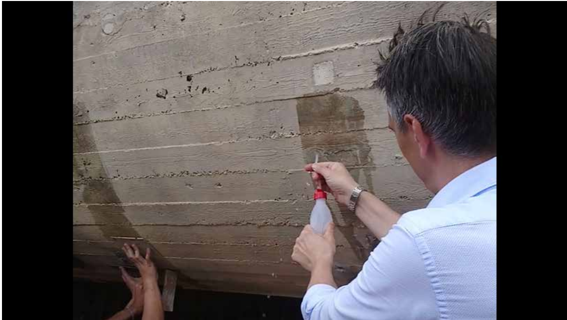
Figura 5: Prueba de impermeabilización con e senza Protect AS IBIX biocare aplicado el 19.02.2020. (video)
