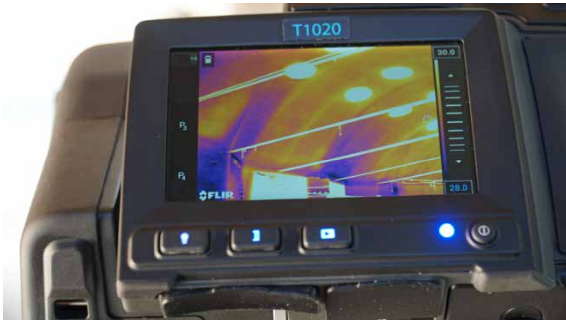
Figura 6: Immagine termografica su BLOCCO 11. Viene evidenziata la presenza di alcuni elementi “tipo nervature” tangenti ai lucernai.
