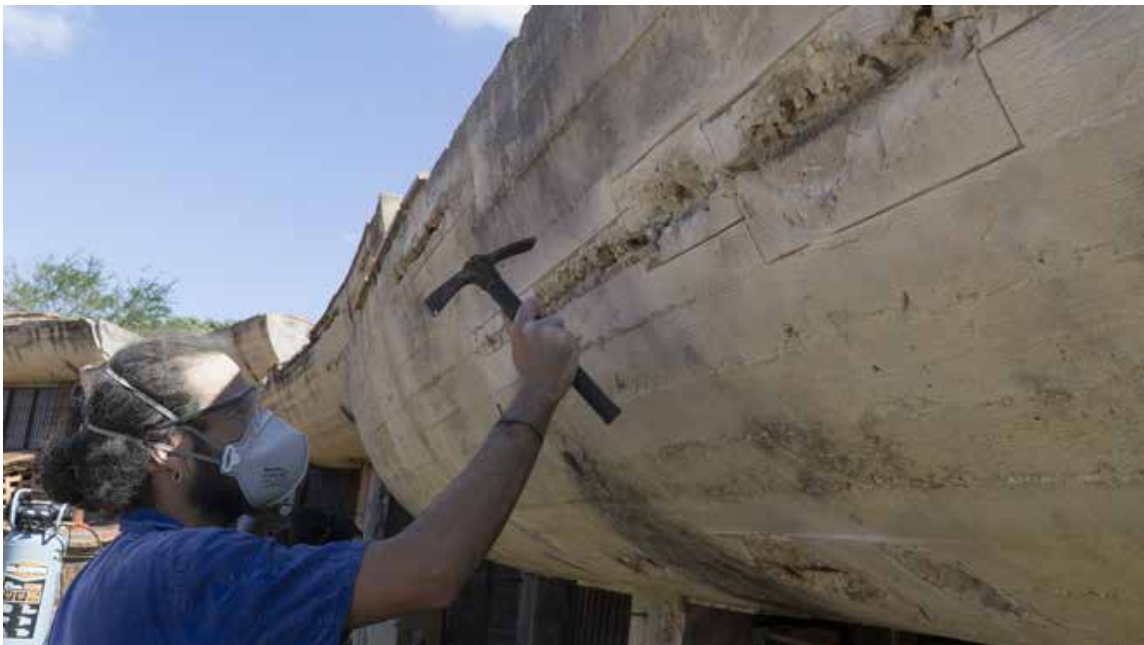
Figura 8: Creazione di scassi di vare forme geometriche in corrispondenza dei ferri scoperti
