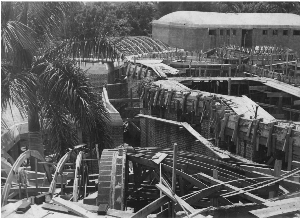
Figura 4 | Fotos históricas de las fases de construcción con sello del Ministerio de Obras Públicas (denominación del mismo Ministerio antes del MICONS). En primer plano la vista de las costillas o guías en detalle, Archivo Gottardi, 1962.
