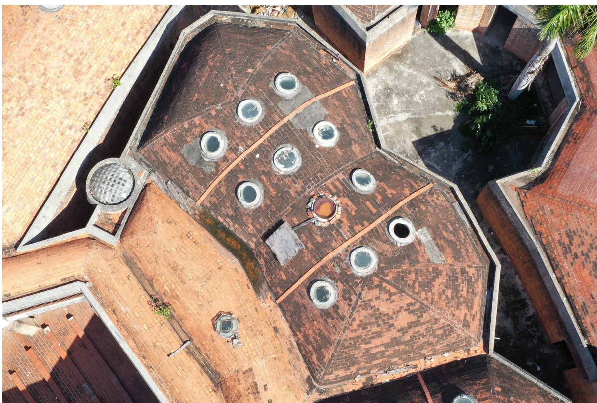
Figuras 10 y 11 | Marilyn Medero Pérez, de las dos muestras tomadas en la bóveda del bloque 9, 04.03.2020. Figura 12 | Grupo de investigación coordinado por el profesor Alessandro Merlo, foto aérea desde el dron en el tejado del bloque 9, 21.10.2019.
