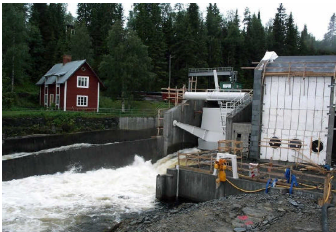
Figura 1: centrale idroelettrica sul fiume Skellefteå, in Svezia.
