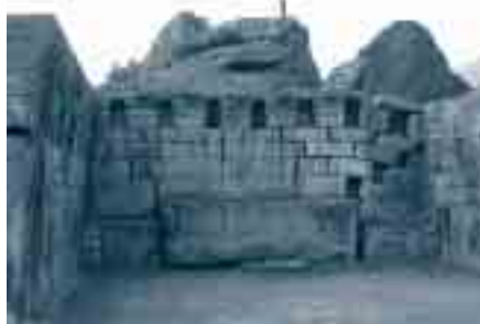
Machu Picchu: deformazioni delle strutture murarie nella Cittadella provocate da processi di dissesto gravitativo.
