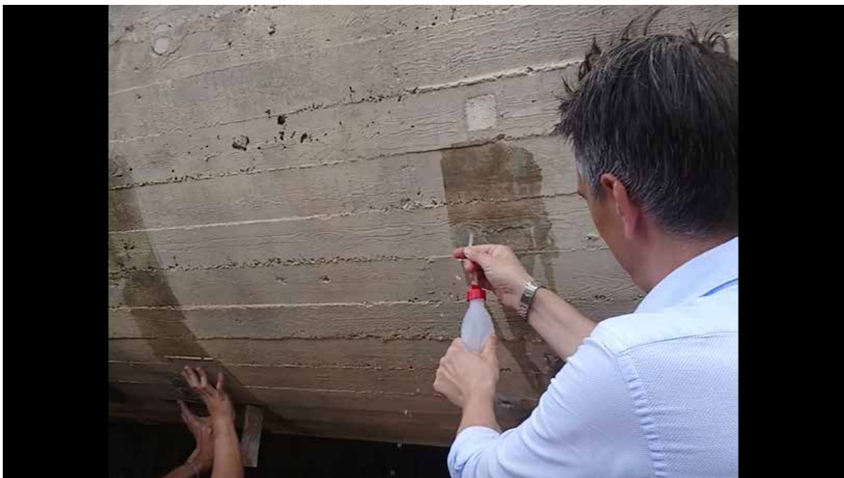
Figura 5 | Prueba de impermeabilidad con y sin Protect AS IBIX biocare aplicada el 19.02.2020. (vídeo).
