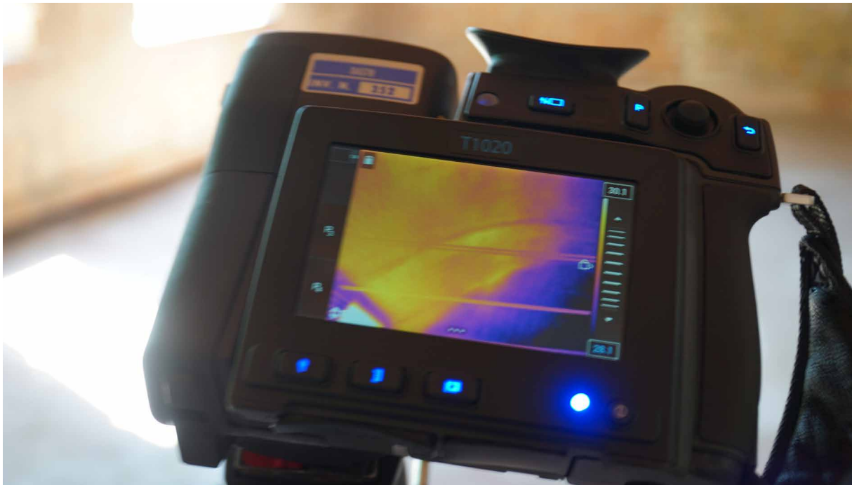
Figura 4 | Imagen termográfica en el BLOQUE 1. Se destaca la presencia de algunos elementos o hierros “tipo costilla” en las bóvedas.
